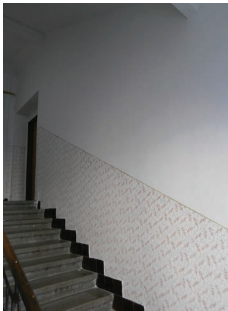
V květnu 2014 byla rekonstruována elektroinstalace společných prostor v domě Štramberská 4, včetně malby schodiště.
