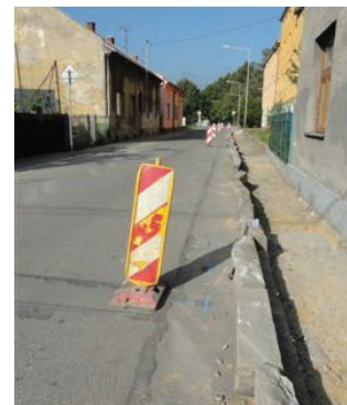
Z rozpočtu obvodu byly realizovány rekonstrukce v ulicích Mečnickovově, Meziuličnické, Pasteurově, Přerušené a Syllabově.
